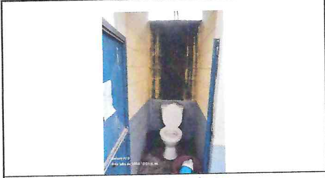
Foto 2: Baños en mal estado
