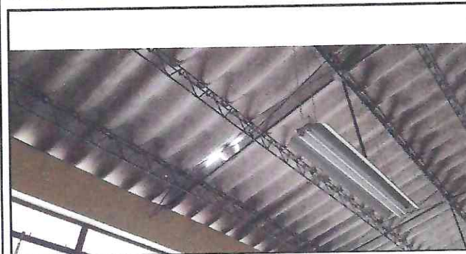
Foto 3: laminas en mal estado
