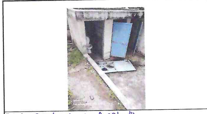
Foto 4: puertos en mal estado
